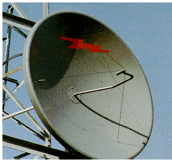
UNI - Antenas de MW
