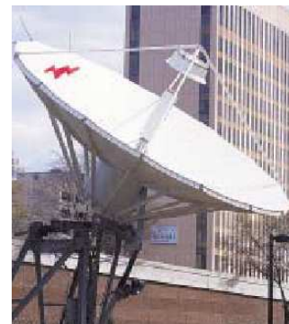
UNI - Antenas de MW
