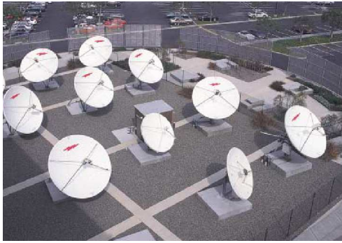
UNI - Antenas de MW
