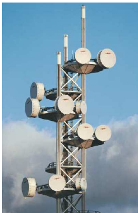
UNI - Antenas de MW
