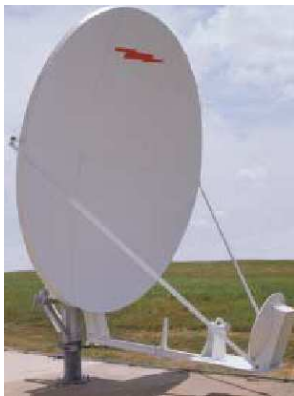
UNI - Antenas de MW
